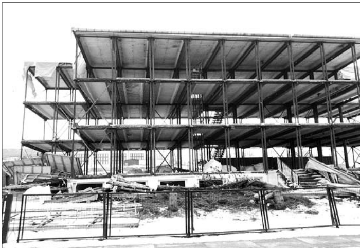
Für eine kurze Zeit war das Innenleben der ehemaligen Kindertagesstätte zu bewundern. Blanke Stahlträger sind die letzten überirdischen Überreste der Einrichtung. Die nächsten Arbeiten finden im Untergrund statt, bevor das Gelände für den Neubau der Sporthalle zur Verfügung steht.
